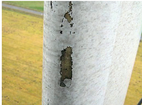
Durch einen Erosionsschaden, hier an der Blattvorderkante eines Rotorblattes, ändern sich die Strömungsbedingungen.
